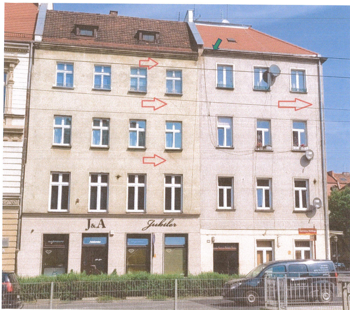
Fot. 2 Widok od ul. Kazimierza Wielkiego pionowej rysy przy narożniku budynku nr 34 na styku ściany elewacyjnej od ul. Eugeniusza Gepperta świadczący o odspojeniu się tej ściany na całej jej wysokości. Zielona strzałka – wadliwie rozwiązanie końca rynny skutkujące zaciekami oraz odpadaniem tynku
