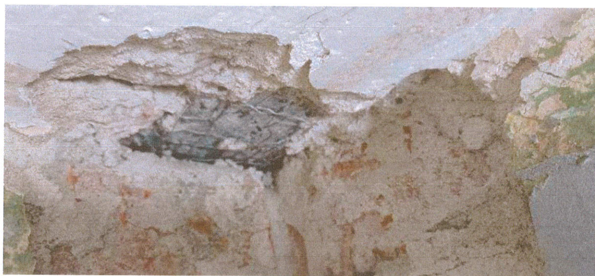
Fot. 29 Otwór w stropie po przewodzie kominowym zatłakany siatką ogrodzeniową z betonem
