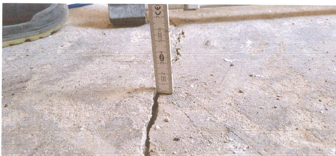
Fot. 17 Uskok o wysokości 5 mm pomiędzy krawędziami pęknięcia płyty stropowej
