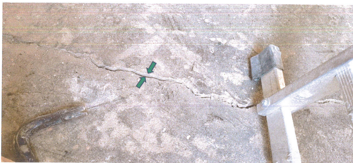
Fot. 15 Bardzo duże (ok. 1 cm) pęknięcie konstrukcji stropu w remontowanym mieszkaniu
