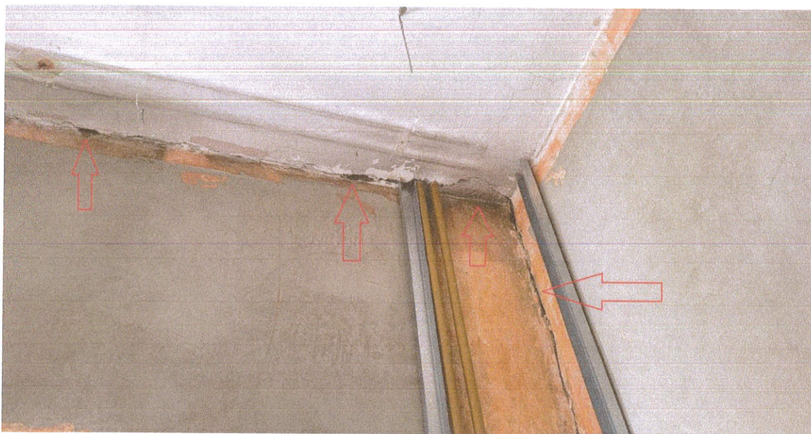
Fot.10 Widok z wnętrza remontowanego mieszkania na zamurowane okno widoczne na fot. 7; widoczne spękania sufitu remontowanego mieszkania oraz wieszaki zdjętego podwieszonego sufitu z płyt gipsowo-kartonowych
