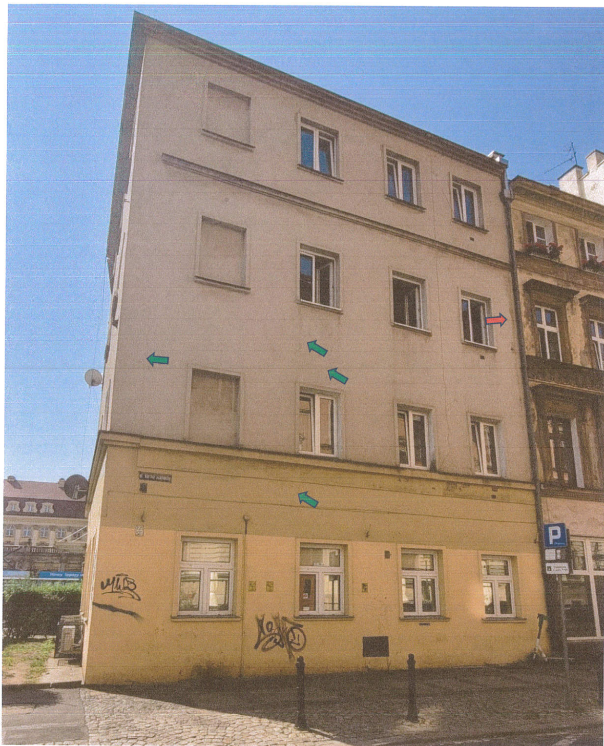
Fot. 5 Stan zarysowania ścian narożnika przedmiotowego budynku ul. Eugeniusza Gepperta oraz ul. Karola Szajnochy – zielone strzałki wskazują największe, widoczne z daleka zarysowania ścian. Zwraca się uwagę na jedną rurę spustową odprowadzającą wody opadowe z dachu dwóch sąsiadujących budynków. Wzdłuż rury spustowej widoczne zbrązowienie tynku (czerwona strzałka) świadczące o wyciekach wody opadowej przez styki fragmentów przepelnionej rury spustowej przy nawalnych deszczach i zbyt dużej powierzchni zlewni dwóch dachów. Przy bruku chodnika widoczne uszkodzenia tynku w postaci czarnych plam spowodowane wyciekami wód opadowych z rury spustowej spływających chodnikiem w stronę (vide fot. 6 poniżej) w stronę jezdni ul. Kazimierza Wielkiego. Uszkodzenia te zaznaczono czerwonymi strzałkami na fot. 6 poniżej.
