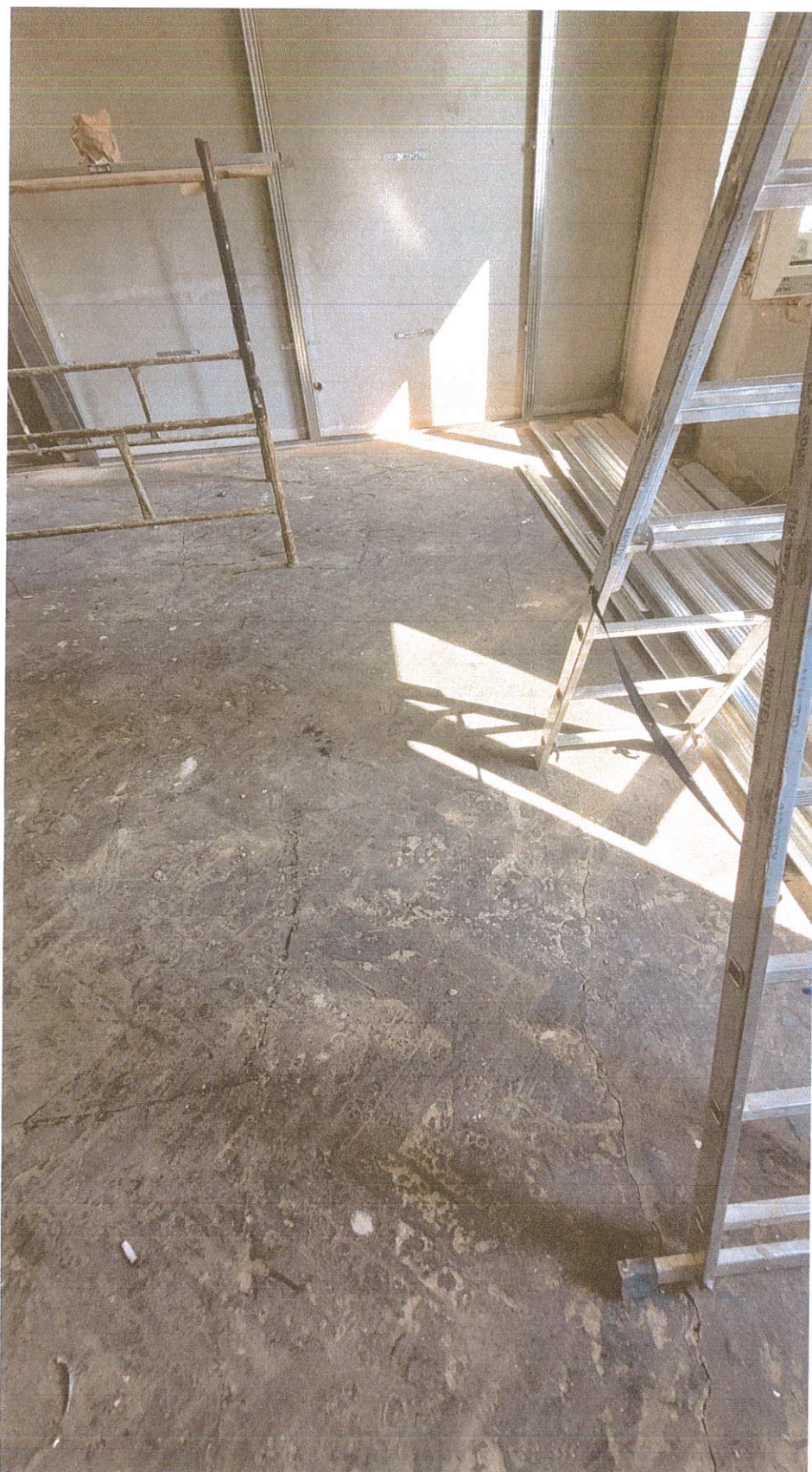
Fot. 18 Skomplikowany układ spękań na powierzchni stropu (podczas remontu nie przeprowadzono iniekcji sklejującej płyty stropowe Kleina)
