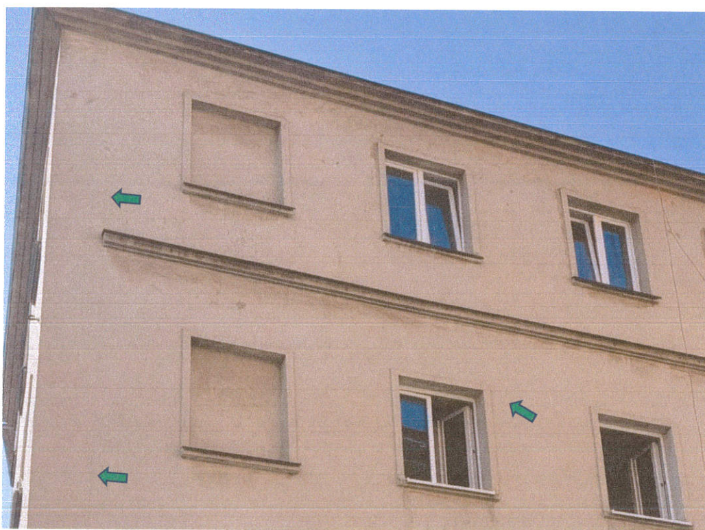
Fot. 7 Rysa na ścianie przy oknie remontowanego mieszkania od strony ul. Eugeniusza Gepperta oraz kontynuacja pionowej rysy przy narożniku ( vide fot. 5)
