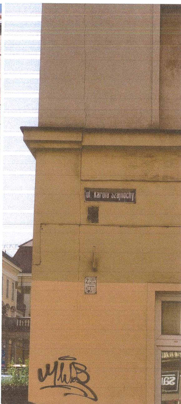
Fot. 4 Widok od strony ul. E. Gepperta (dawniej K. Szajnoch) pionowej rysy przy narożniku na całej wysokości budynku - analogiczne zarysowanie od strony ul. Kazimierza Wielkiego (vide fot. 2 i 5)
