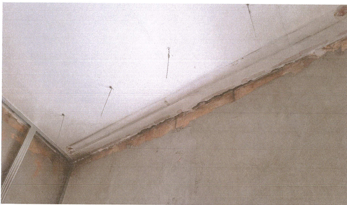
Fot. 11 Widok z wnętrza remontowanego mieszkania na spękania sufitu na stykach elementów konstrukcji nośnej stropu (tzw. „klawiszowanie”) świadczące o ruchach budynku spowodowanych osiadaniem ław fundamentowych; także na ścianie widoczny element aluminiowego rusztu nośnego płyt gipsowo-kartonowych, zaś na suficie wieszaki zdemontowanych elementów rusztu podwieszonego sufitu mającego za zadanie maskowania licznych spękań konstrukcji sufitu (fot. 12)
