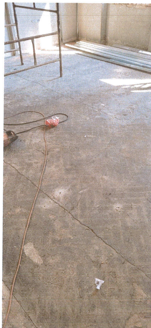
Fot. 14 Duże spękania stropu mieszkania
