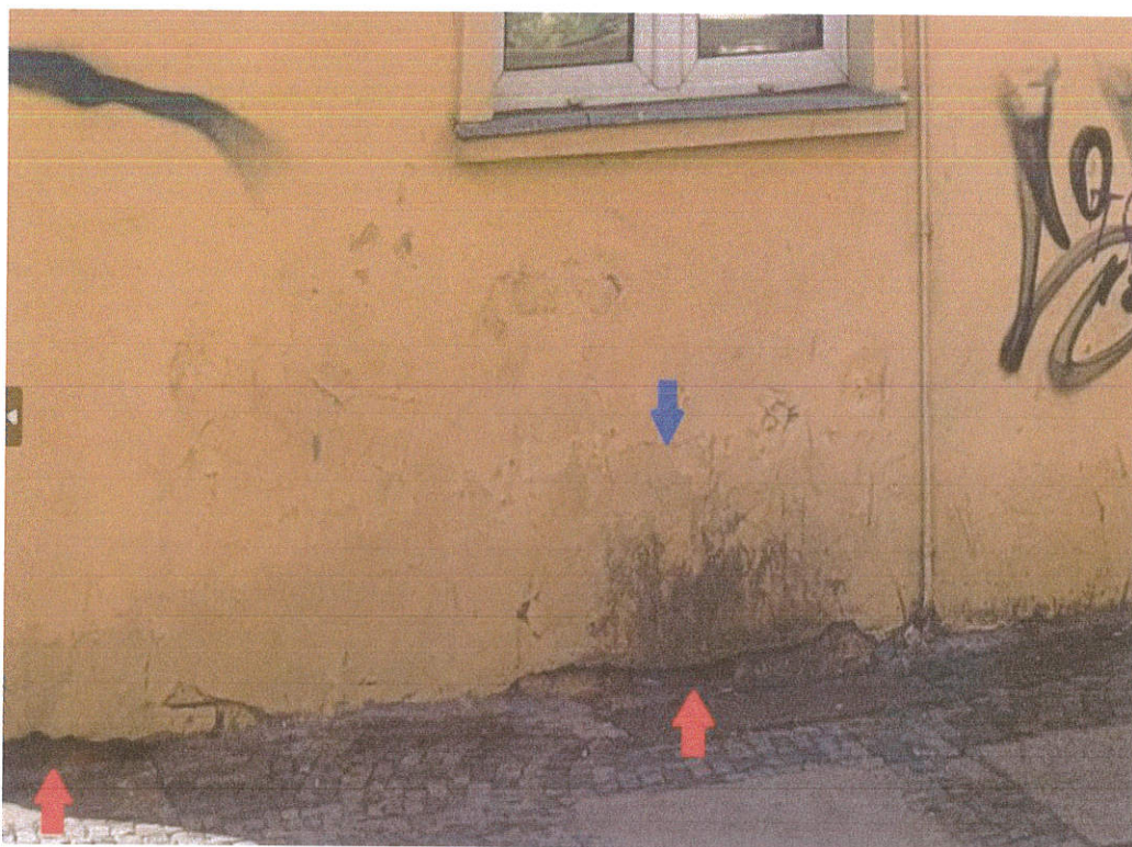
Fot. 6 Stan uszkodzenia dołu ściany przedmiotowego budynku od strony ul. Eugeniusza Gepperta – widoczny brak ochronnego cokołu. Czerwonymi strzałkami oznaczono wymyty wodami opadowymi tynk i spoiny cegieł w murze. Granatową strzałką oznaczono zarysowanie poziome na tynku ściany
